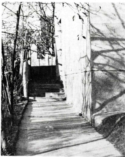
Obr. 3. Naklonené obvodové murivo, chodník a schodíky na obytnom dome v Zavare
