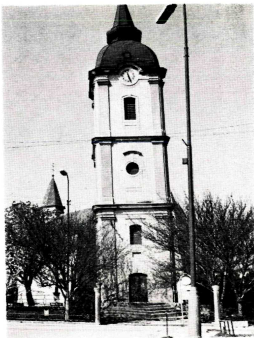
Obr. 2. „Šikmá veža“ vo Vrbovom. Zvonica postavená r. 1835 sa začala nakláňať r. 1930 v dôsledku rôznych rekonštrukčných a prístavbových prác. Aj po sanačných opatreniach pohyby neprestali, čo môžeme vidieť aj na polámaných schodoch
